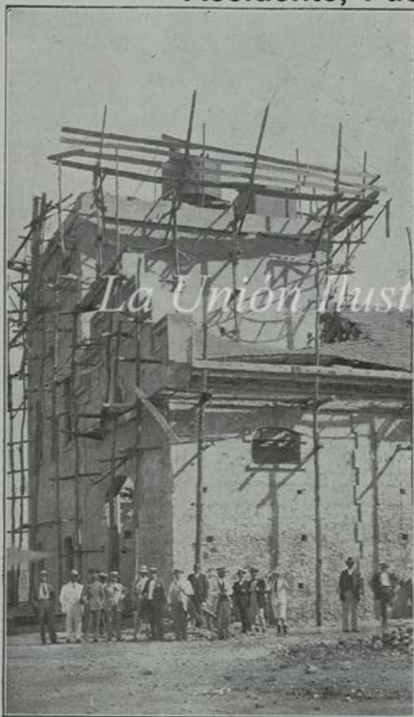
Colonia de San Pedro Alcántara Fábrica en construcción donde ocurrió el desprendimiento de una cornisa, que aplastó a varias personas
